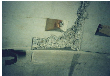
Figure 8: Edge spalling [Foto Kolić]
